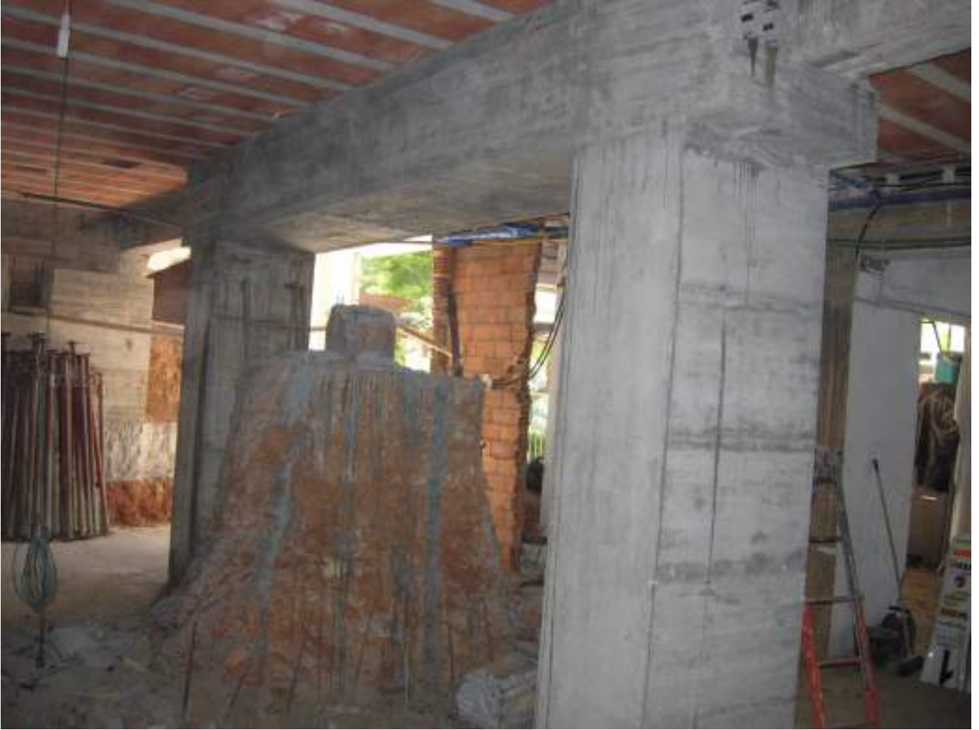
Foto 12 – L'accurata predisposizione e cura lavorativa non ha permesso traccia della preesistente situazione.
