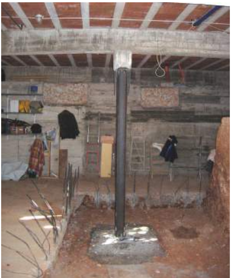
Foto 5 Recupero dei martinetti idraulici e preparazione dell'area per la ricostruzione del nuovo plinto e nuovo pilastro. Sul fondo si notino incassati nel muro perimetrale due dei plinti primigeni.
